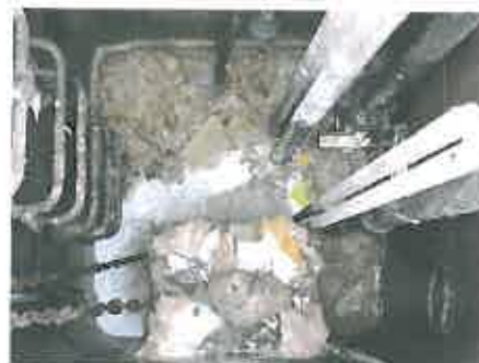
Poste de refoulement du SIARP obstrué par des lingettes
