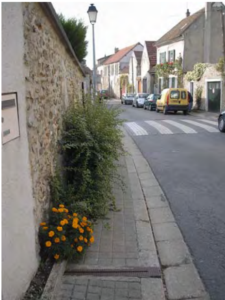
Rue Saint Didier : ces plantations en pied de mur ne sont pas adaptées à l'espace car elles empêchent le cheminement du piéton sur un trottoir qui est déjà très étroit. Une plante grimpante serait bienvenue.
