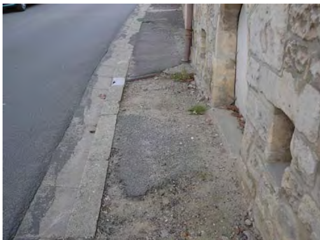
Trottoir en enrobé en très mauvais état. La bordure en béton et le caniveau en béton ne sont pas le traitement adapté pour la rue principale du village.
